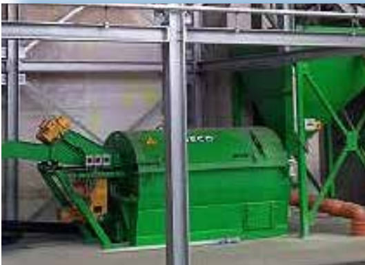
FLOTMAT-03-Vibro esierottelijalla ja kuivastärykuljettimella.
